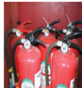
△ 소화기 집적 사례 ※ 보행거리 기준 소형소화기 20m 이내 대형소화기 30m 이내
