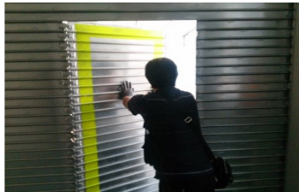
방화셔터 내부 비상구 확인
