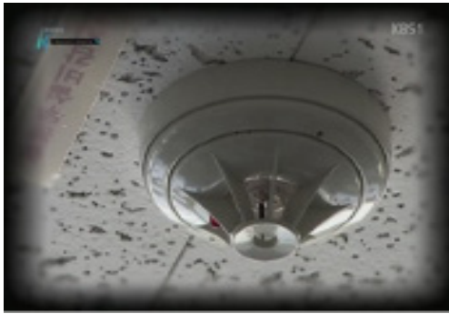
구획된 실에 적절하게 설치된 감지기
