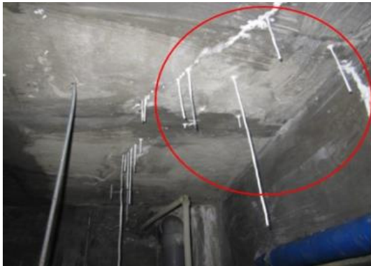
천장슬래브 균열 및 누수
