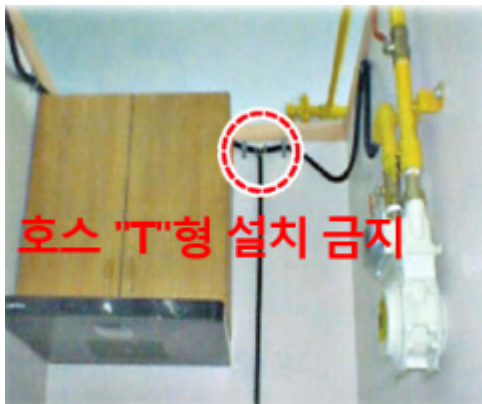
호스 T형 설치 금지
