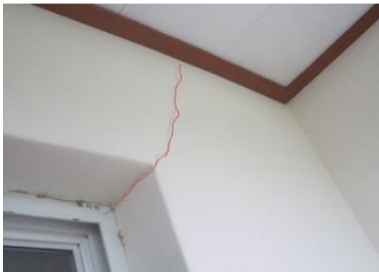
개구부 취약부위 집중 균열
