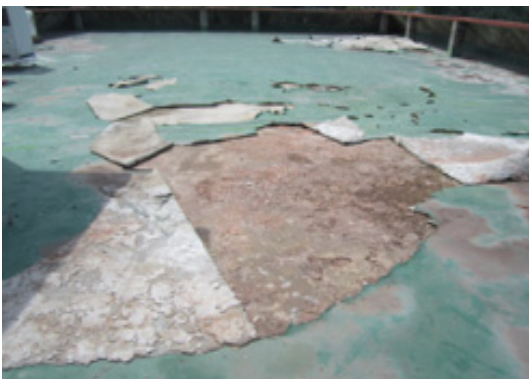
옥상 우레탄 방수층 파손
