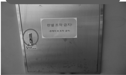
전원 분전반 잠금장치 시설
