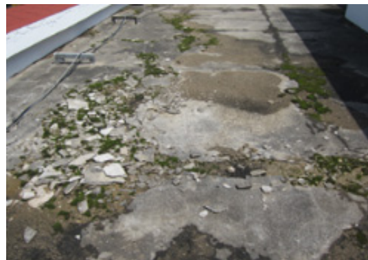
지붕 방수층 누름콘크리트 파손
