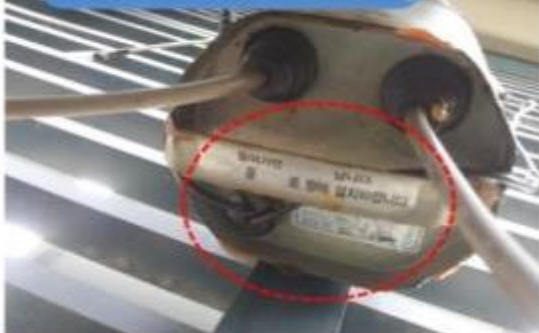
네온변압기 접지 미시설
