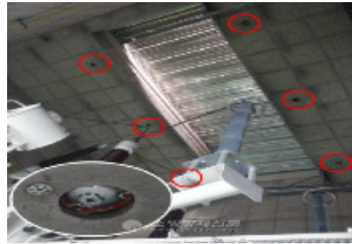
감지기 부적정 설치(매립 및 망사덮개)
