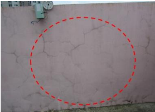
지붕 파라펫 미장면 건조수축 균열
