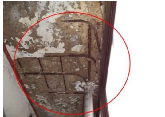
콘크리트 박락 및 철근 노출
