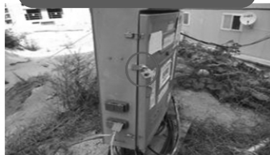
옥외 간이 분전반 잠금장치 시설
