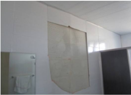
화장실 벽타일 균열 및 탈락
