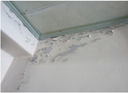
벽체 도장 노후 및 탈락
