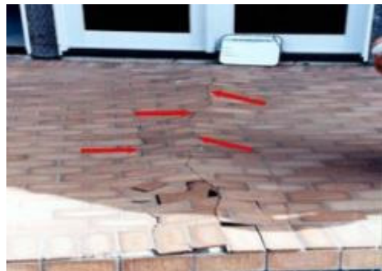
지반침하 바닥 슬래브 파손
