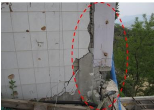
지반침하 벽체 구조물 파손
