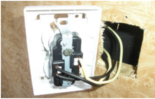
콘센트 접지 미시설 및 난연 박스 미사용
