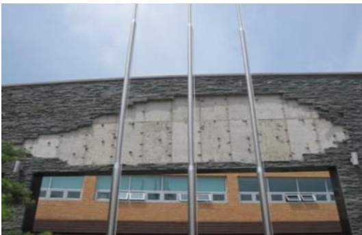
외부 마감재 손상 및 탈락
